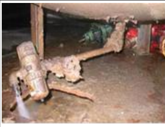
空氣桶下方祛水洩漏
