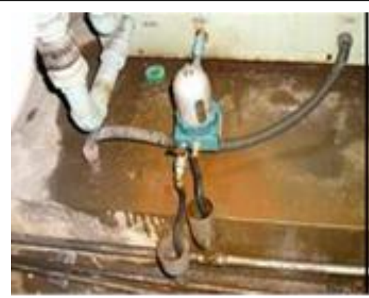
浮球式祛水器排水洩漏
