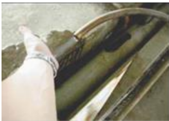
離心式中間段祛水洩漏
