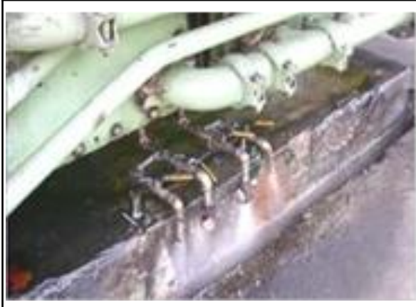
離心式中間段祛水洩漏
