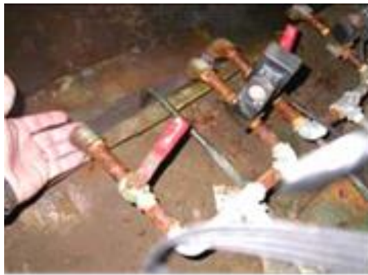
電子式祛水器排水洩漏
