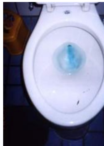
低水箱馬桶測漏—微漏
